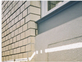
TAZ Redaktionsgebäude in Berlin Kreuzberg Instandsetzung der Hoffront
